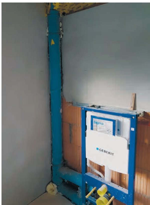
Hier sind gleich zwei Fehler passiert: Die Wand hinter der Vorwandinstallation und dem Rohr ist nicht verputzt und das Rohr liegt zu dicht an der Wand und kann oben nicht rundum abgedichtet werden.
